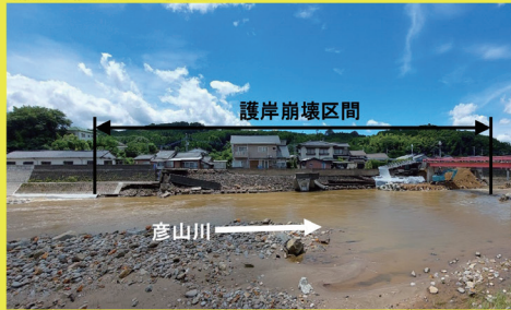
被災状況（7 月 11 日撮影）
