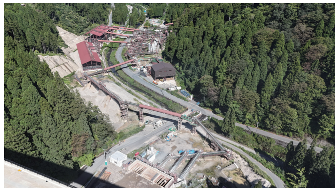
骨材製造設備
