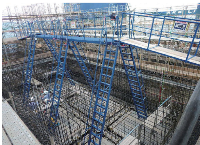
安全ブロック付専用足場
