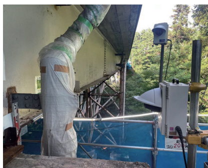
ネットワークカメラ設置状況
