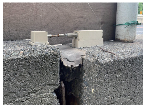
構造物変位遠隔モニタリングシステム設置状況
