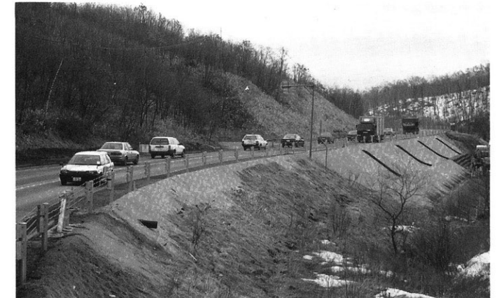
一般国道272号標茶町東阿歴内道路災害応急復旧工事 (工期 H5.1.27~H5.3.25)
