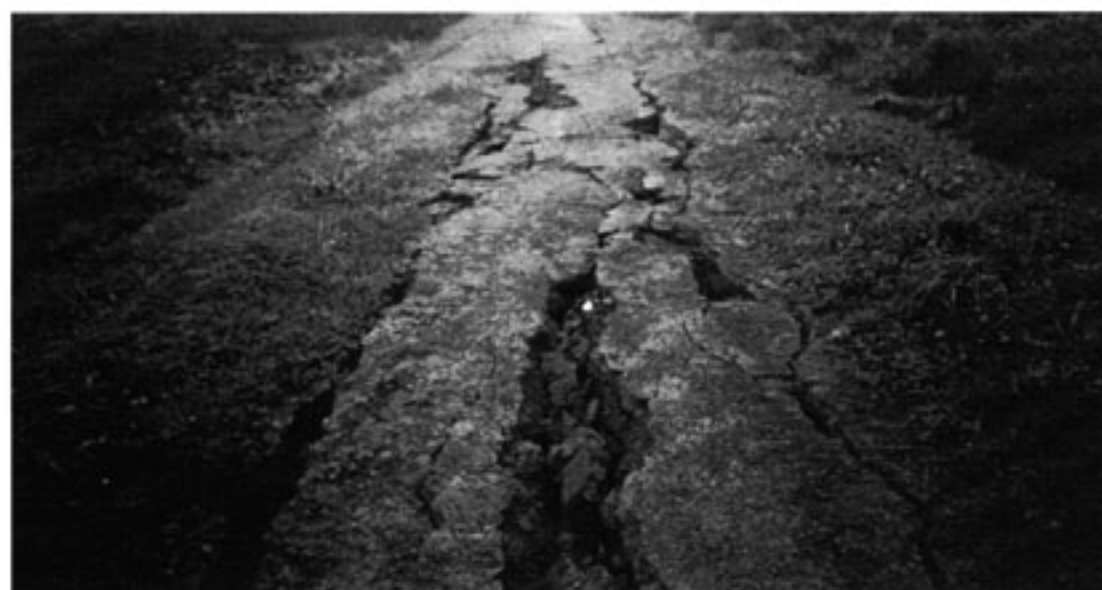
▲標津川堤防天端の亀裂
