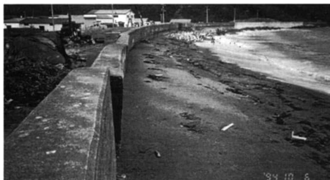
▲散布漁港海岸 防潮堤の沈下・傾斜
