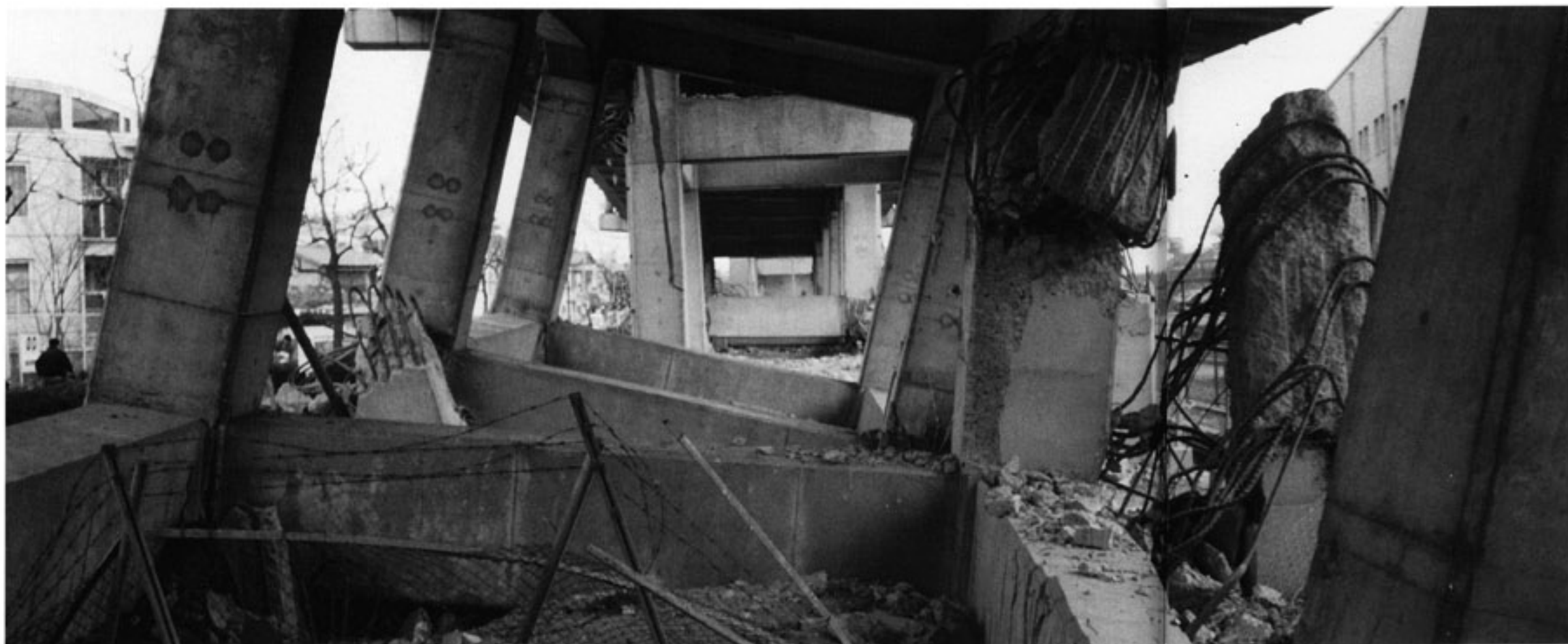
鉄道高架部の被害
