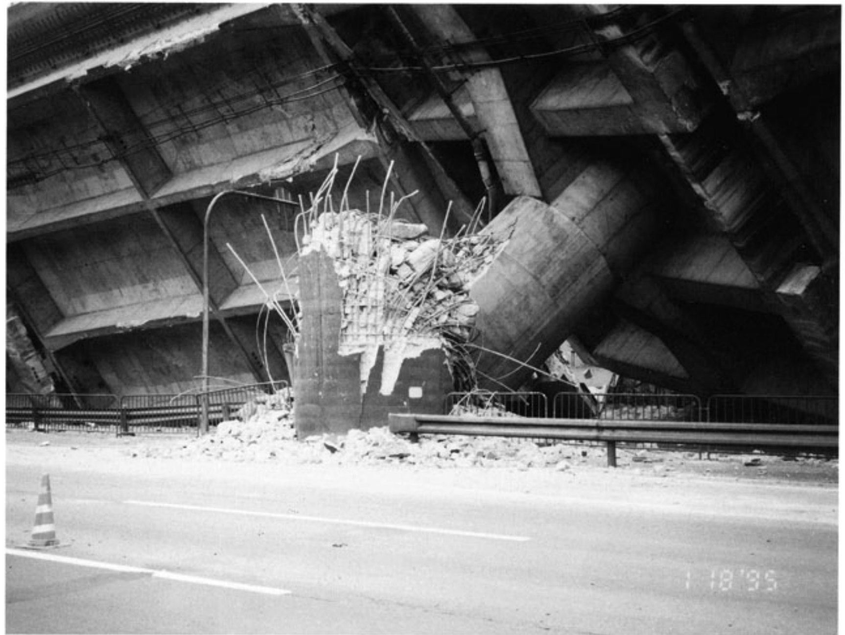
▼倒壊した阪神高速道路の橋脚
