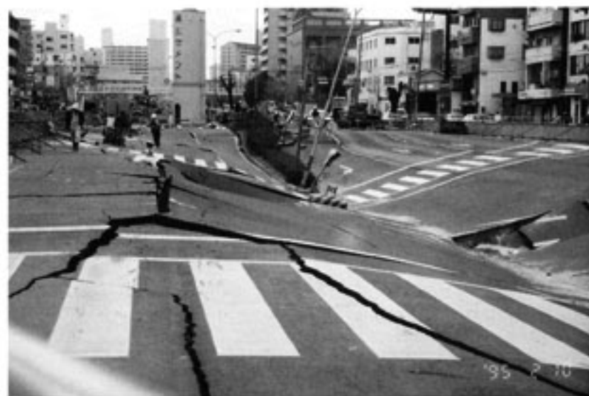
▲大開駅 路上陥没状況 (写真提供: 札幌市交通局)
