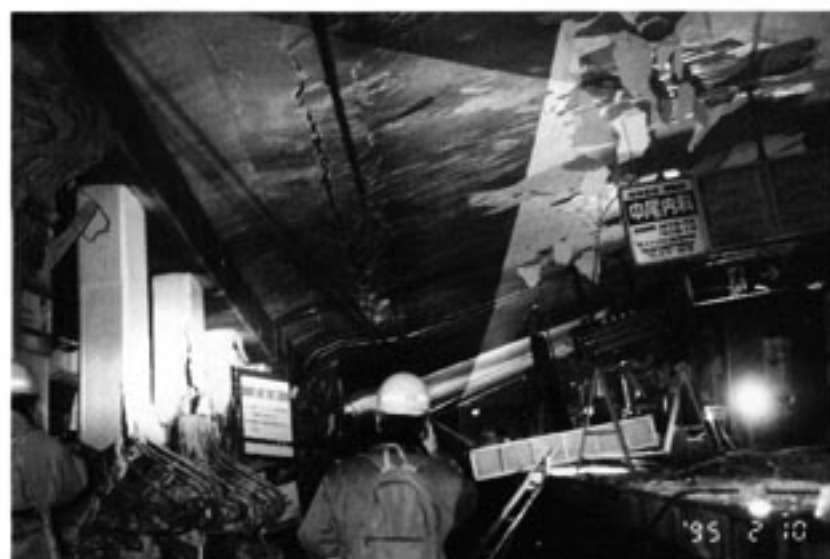
▲大開駅 軌道階、上床落下状況 (写真提供: 札幌市交通局)
