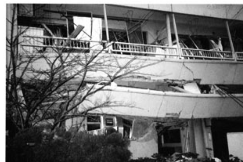
▲高層住宅の破損状況 (写真提供: 札幌市消防局)
