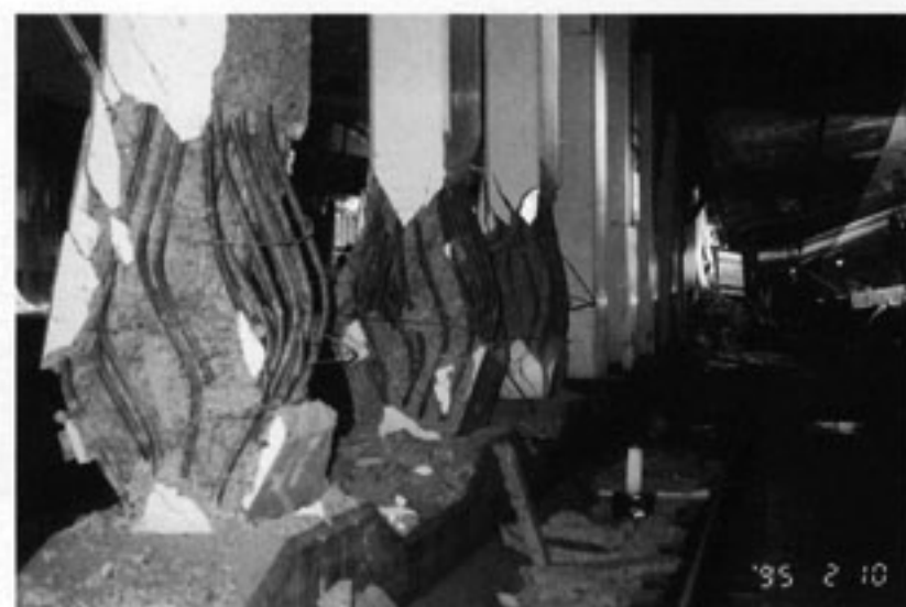
▲大開駅 軌道階、中柱の下部の破損状況 (写真提供: 札幌市交通局)
