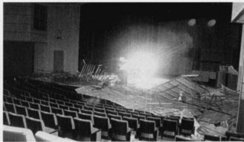
▲根室市文化会館大ホール 天井部の落下
