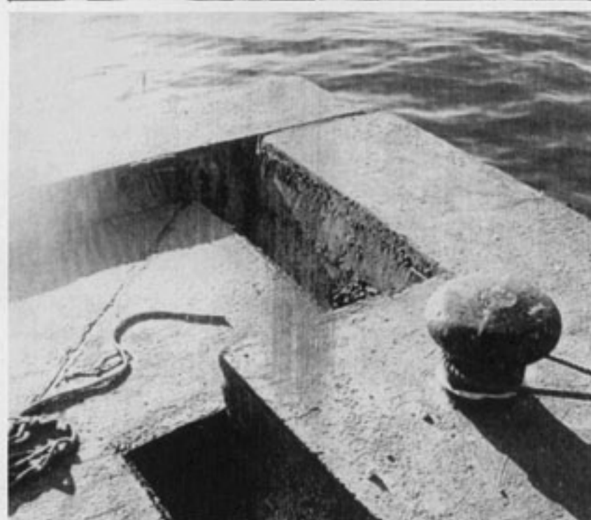
▲羅臼町 松法漁港中央埠頭先端部陥没
