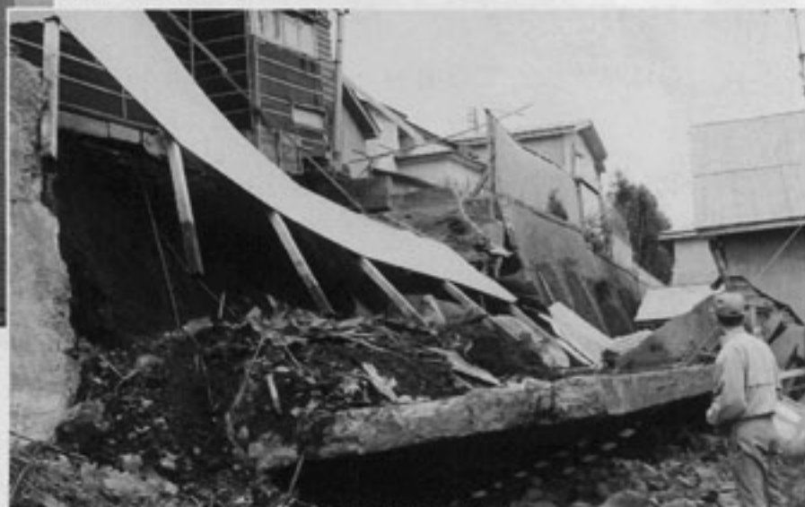
▲斜面を固めていたコンクリートがはがれ落ちた
