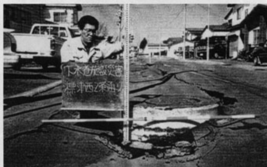
▲マンホールの浮上・路面沈下・汚水管の蛇行・屈折・上下凹凸
