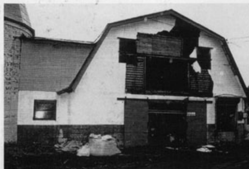
▲茶志骨地区 牛舎外壁剥離
