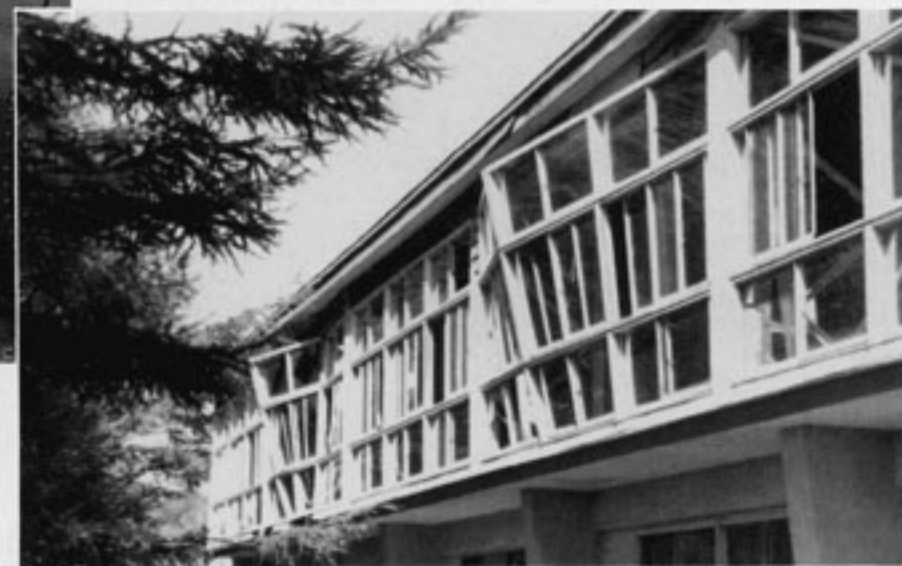
▲町民第二体育館窓破損
