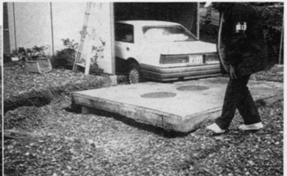
▲共栄町地区合併浄化槽液状化現象
