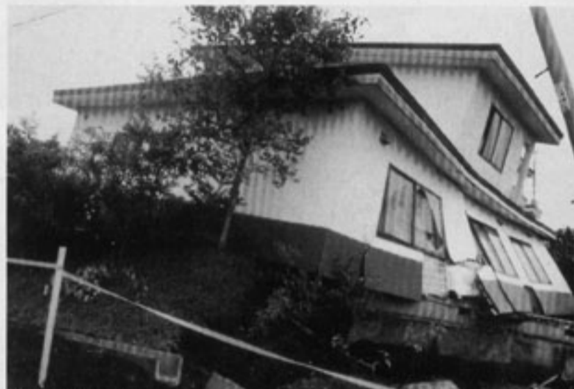
▲家屋の破損状況
