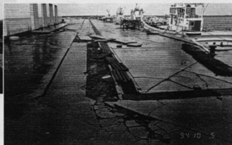
▲地震後の津波によりアスファルトが剥離
