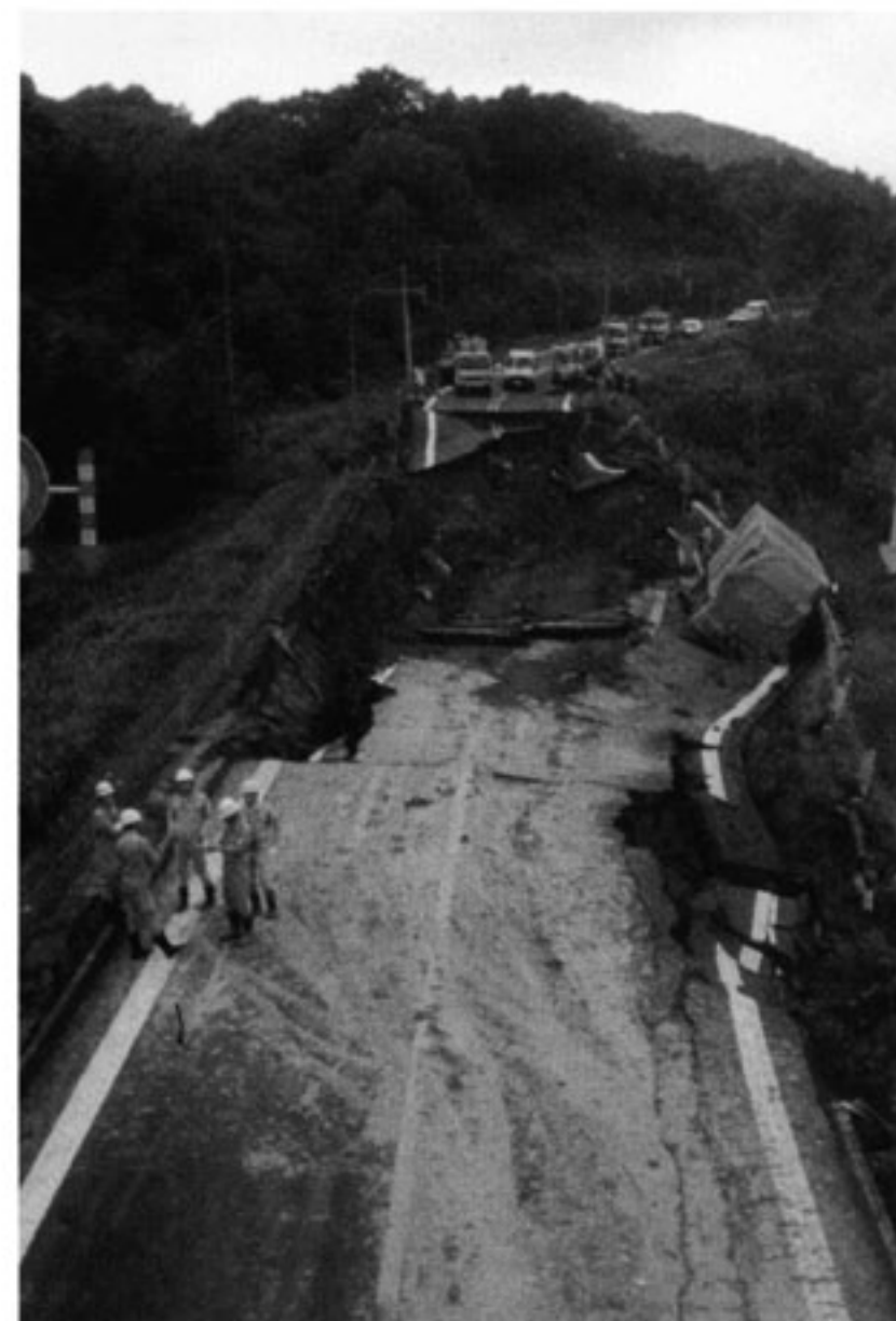
▲一般国道5号長万部町知来の被害状況 100mに渡って盛土が崩壊 平成5年12月に復旧
