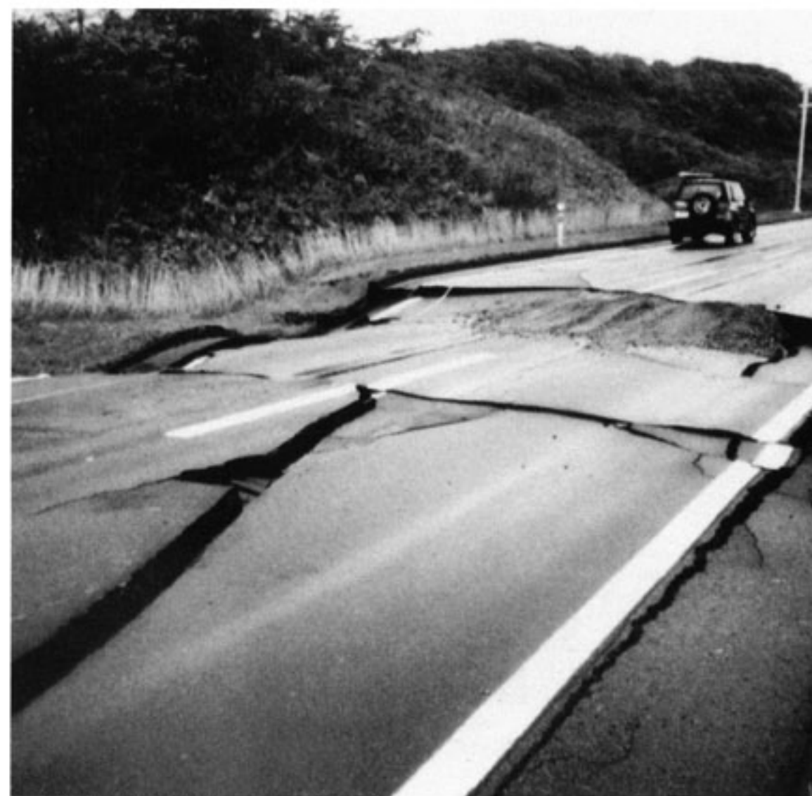
▲一般国道272号標茶町中茶安別 路面の陥没
