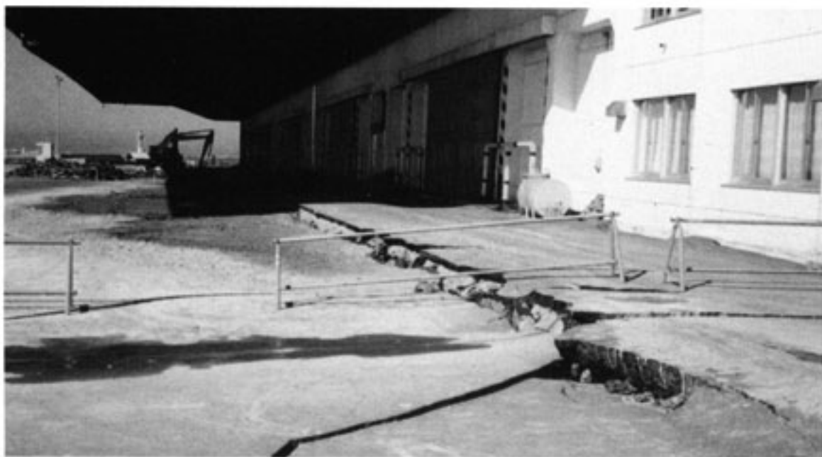
▲釧路漁港埠頭-9m岸壁地盤沈下による亀裂
