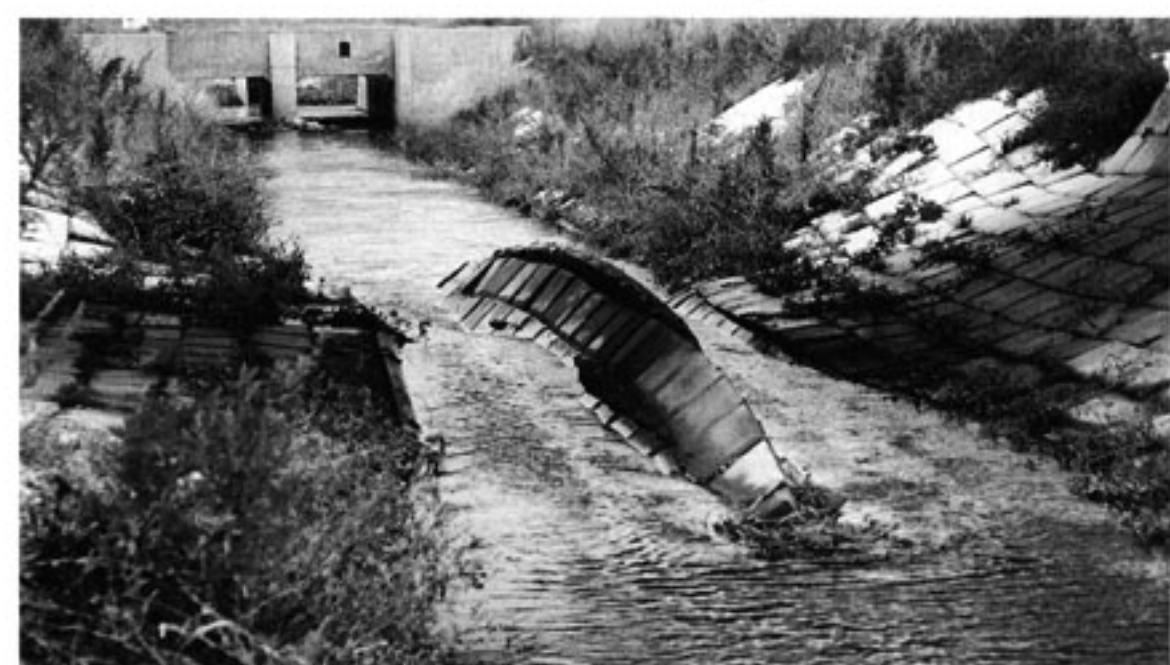
西別地区 4号支線明渠排水 護岸ブロックの法面部沈下による河床部の隆起
